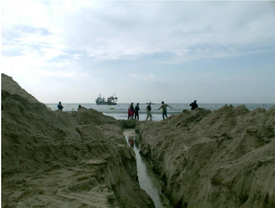
Figure B-18 : photographie montrant la fin du déploiement du câble électro-optique sur la plage des Sablettes à la Seyne-sur-Mer.
